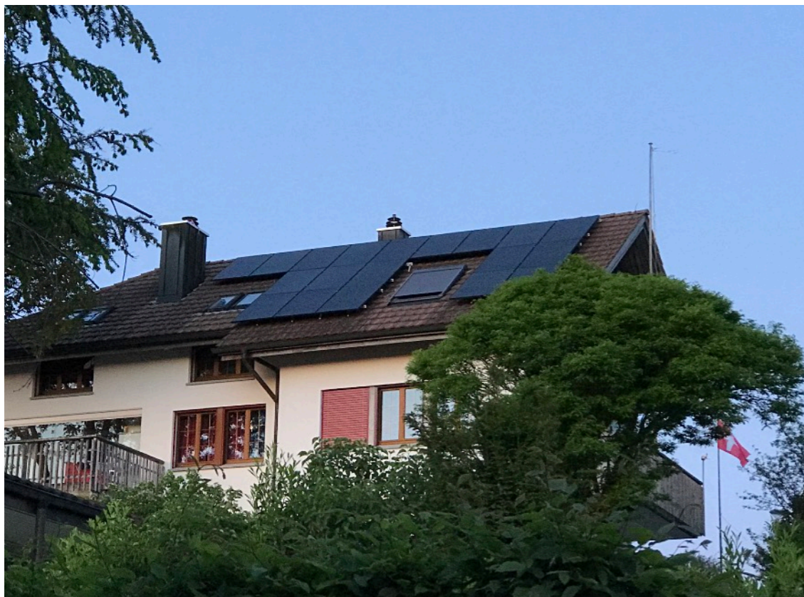
2019 Ergänzung mit 19 Modulen à 300 W > 5.7 kWp
